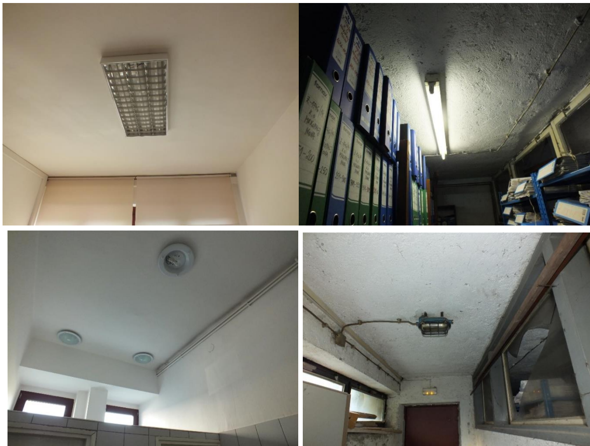
Slika 1. Primjeri postojeće rasvjetne armature
